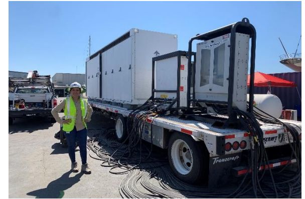
MBESS at port tenant site
