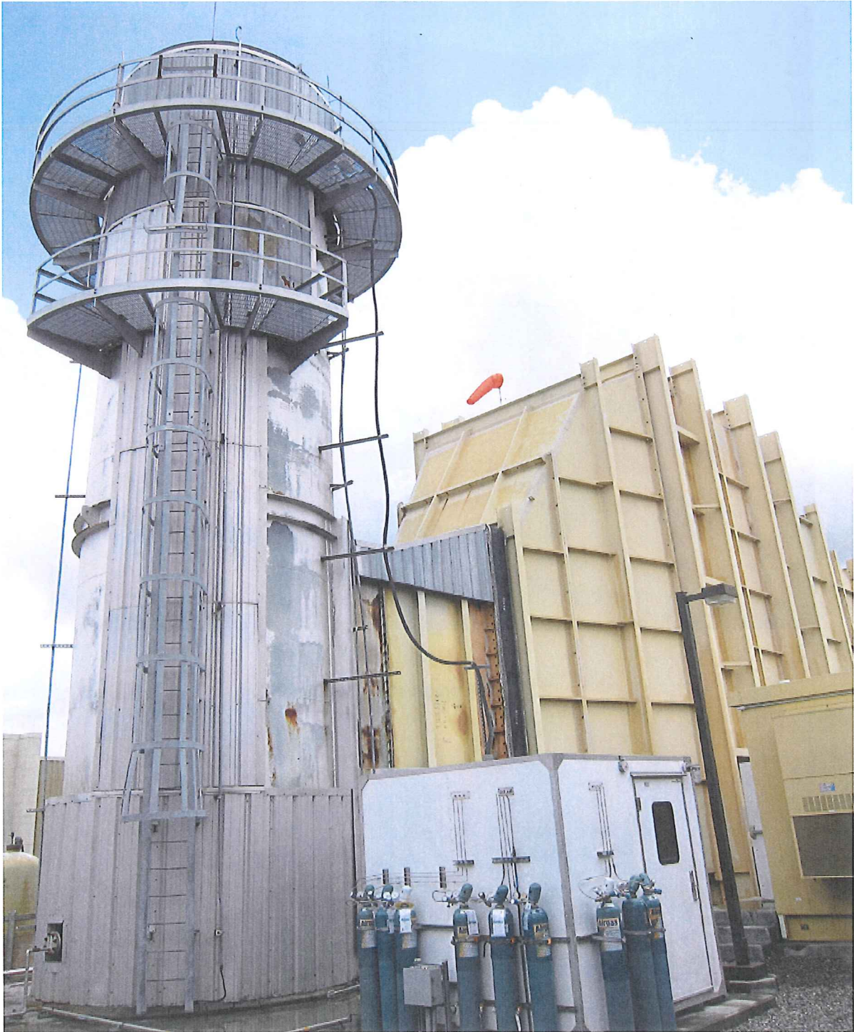
Stack, HRSG and CEMS Shelter
