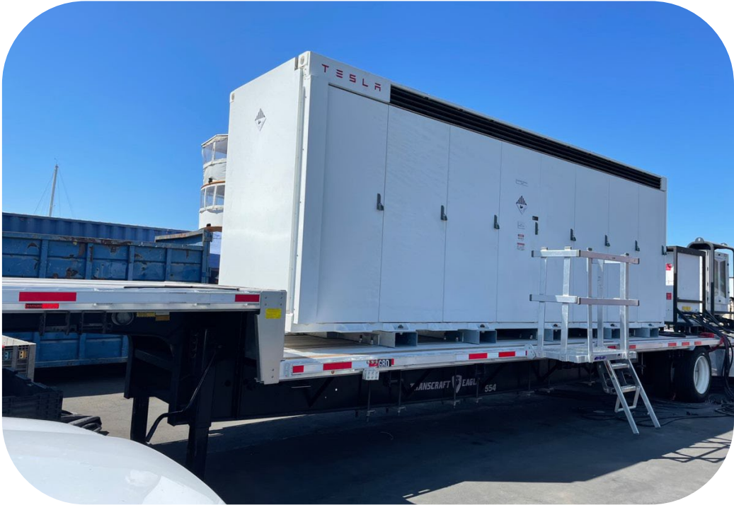
362kW/1500kWh 480V 3Phase
